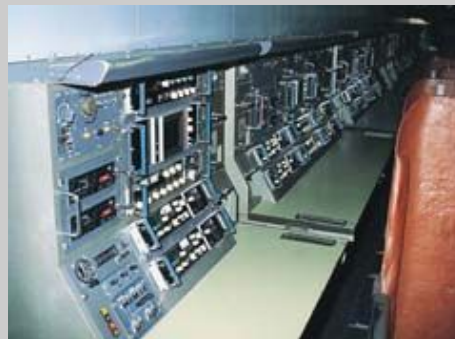
A l'intérieur du F-RAFE
